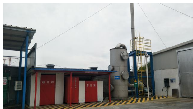
暂存库废气处理设施
