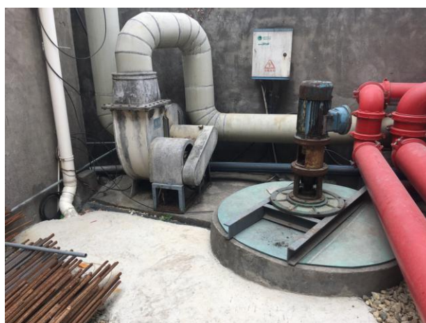
危废库废水收集池及废气引风机
