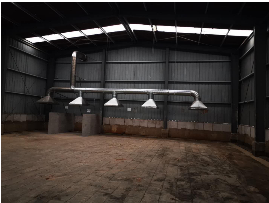
危废暂存间内废气处理设施一套
