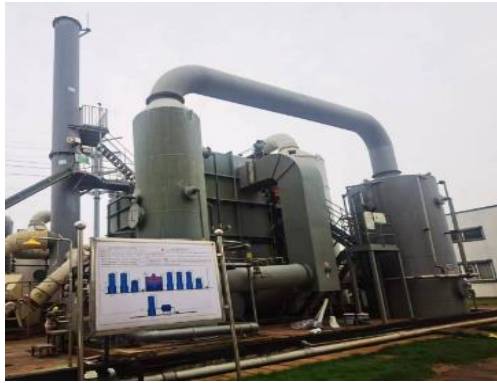
RTO 废气处理装置
