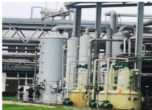
综合回收车间废气预处理装置
