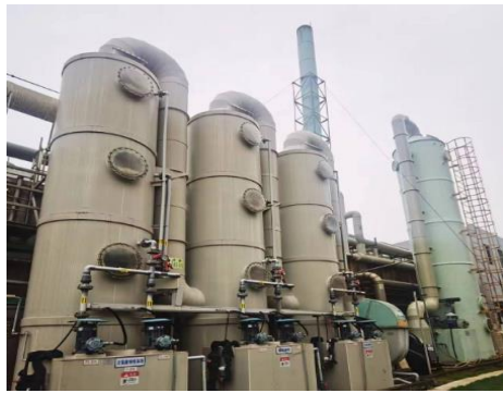
污水处理站废气处理装置
