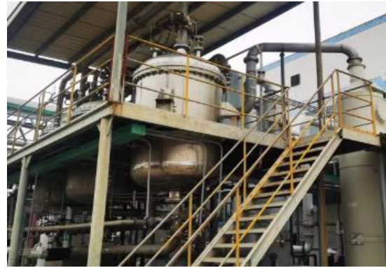
合成二车间废气预处理装置
