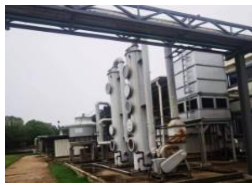
中试车间(非头孢)废气预处理装置
