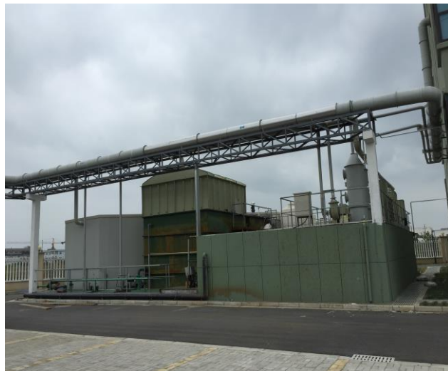
废水预处理装置（新建）
