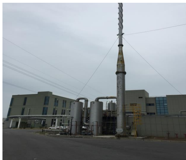
废气 RTO 焚烧装置
