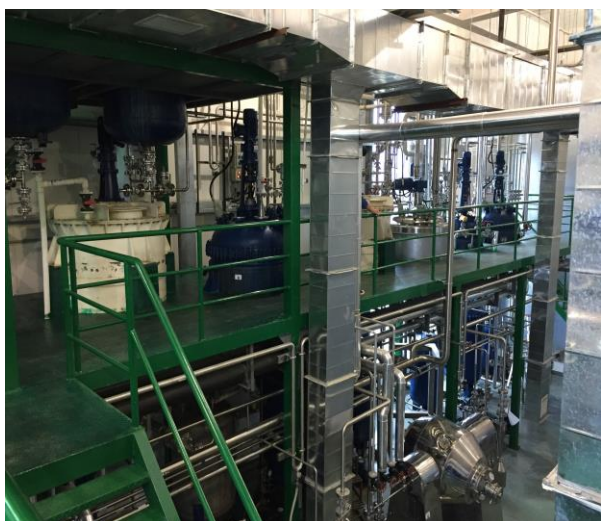
苯达赖氨酸中间体生产车间（内）
