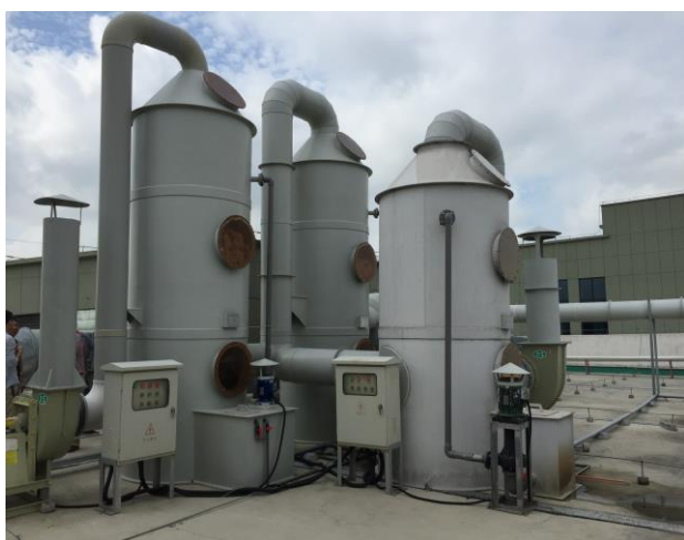
固废暂存间废气处理设施
