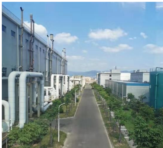
厂区供热母管 1
