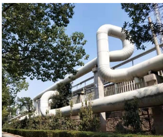
热网 1 号线主管及 2 号线美特康支管
