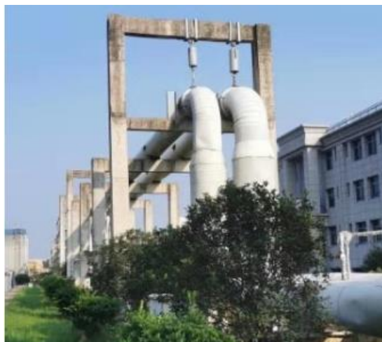
厂区供热母管 2
