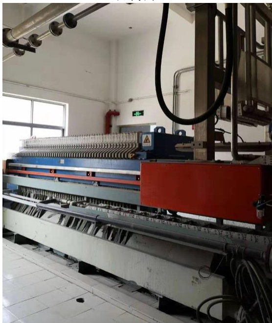
脱硫污泥处理设施
